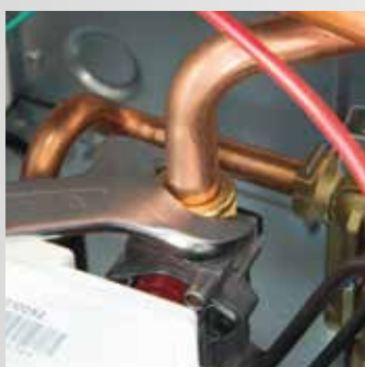
Uvolnění potrubí plynového ventilu
