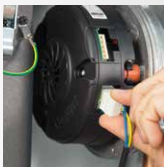
Elektrické odpojení ventilátoru
