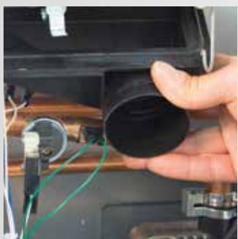
Vytočení sběrače kondenzátu
